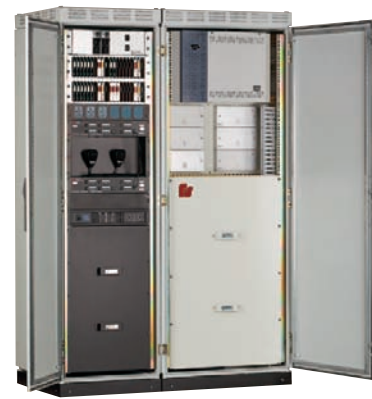
Sistema ECHO montado en bastidor
